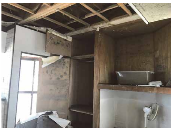
【家内の浸水被害の様子】
